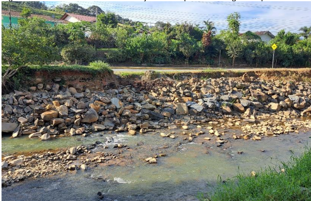
Figura 28: Processo de erosão fluvial a jusante da ponte na margem esquerda do Rio Garrafão.
