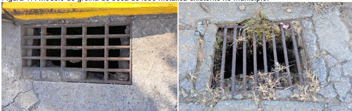
Figura 17: Modelo de grelha de boca de lobo metálica existente no município.
