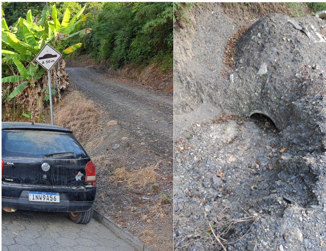
Figura 30: Via sem pavimento e entrada do trecho tubulado parcialmente obstruída (P1) – em 04/2024.
