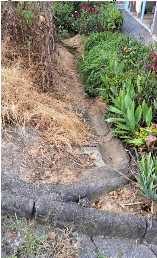
Figura 33: Área afetada por alagamentos.
